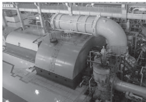
タービン発電機
