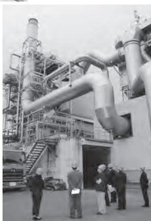
真庭市の一般家庭電力ならまかなえる 巨大な発電設備
