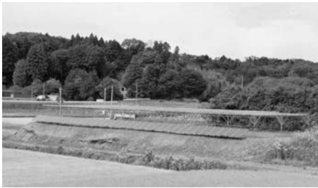
法面も生かしてパネルを設置した東後迫発電所
