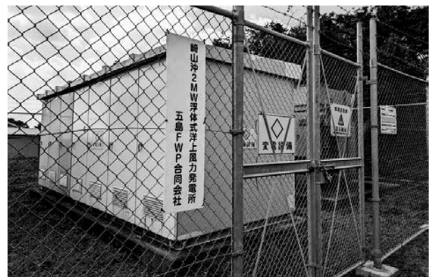
「はえんかぜ」の陸上変電施設
