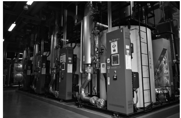
十勝主管工場のボイラ。LBMを燃料として活用
