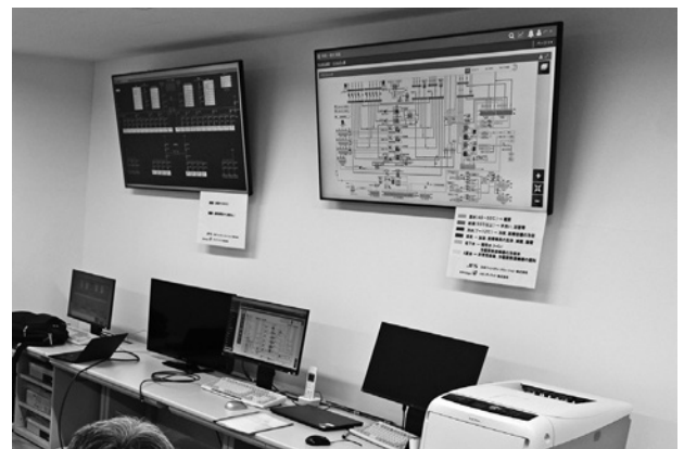
エネルギーセンター棟 (管理モニター)
