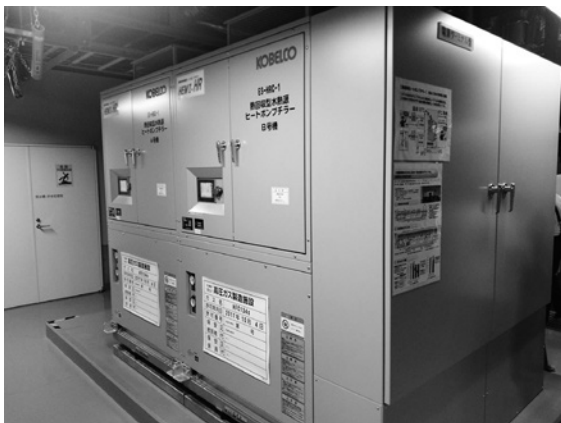
リサイクルエネルギーに大きな威力を発揮する熱回収ヒートポンプ（エネルギーセンター棟）
