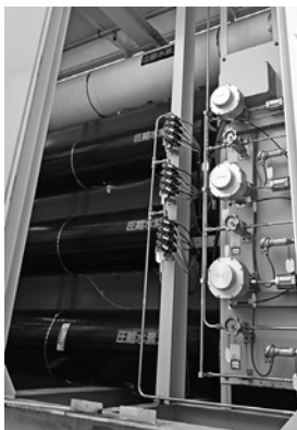
水素を高圧のまま貯蔵する蓄圧器ユニット
