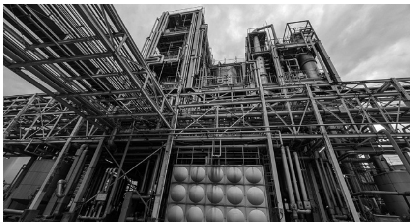
“ボトルtoボトル”循環を何度でも繰り返すことができる ケミカルリサイクルの国内唯一の商用プラント。製造能力は年2万2000トン
