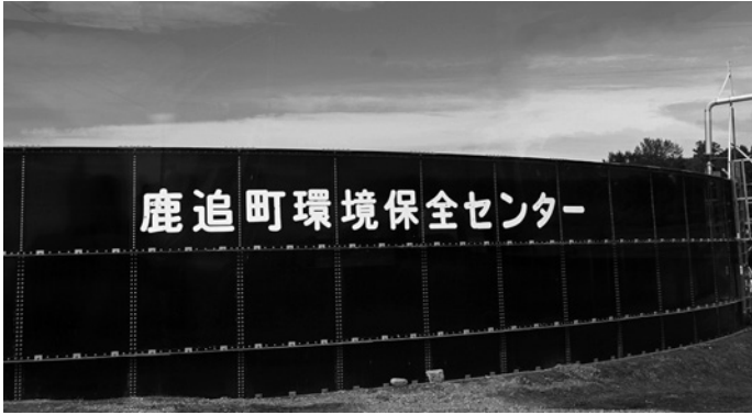
鹿追町が運営する環境保全センター中鹿追バイオガスプラント。 集中処理型としては国内最大規模
